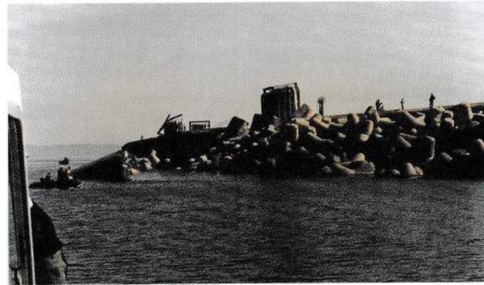
De havenautoriteiten van Skikda zijn volop bezig met het opnemen van de schade aan de havenfaciliteiten.
