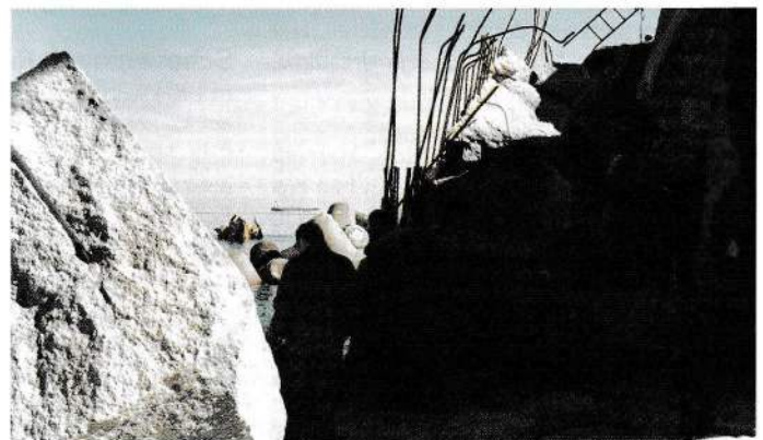
Een gedeelte van de zware betonnen fundering, die totaal is afgescheurd. Op de achtergrond zijn de restanten zichtbaar van een klein gedeelte van het achterschip.
